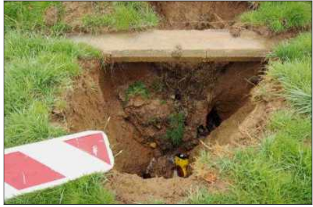
Abb. 13: Am 5. April 2022 war der Erdfall als Ponor aktiv und nahm das auf der Betonsohlschale herangeleitete Wasser auf.
