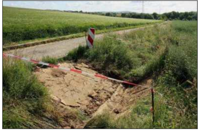
Abb. 17: Die verfüllte Doline mit frisch modellierten Grabenböschungen. Leider wurde keine Möglichkeit geschaffen, durch die anfallendes Wasser sicher in den Untergrund geleitet werden kann. Ein erneutes Einbrechen der Doline ist somit zu erwarten.
