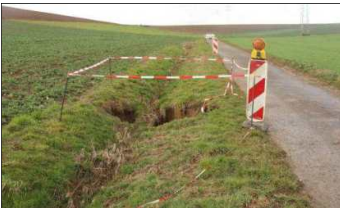
Abb. 1: Mit Flatterband gesicherter Dolineneinbruch bei Zwingelhausen, entstanden Anfang 2022 neben einem Feldweg.
