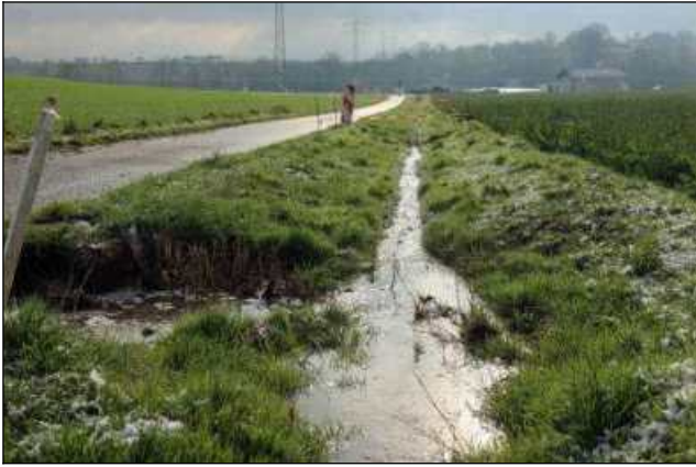
Abb. 16: Der Bach versickerte am 9. April 2022 vollständig in der Doline. Links Erosionserscheinung, verursacht durch Wasser, das an dieser Stelle vom asphaltierten Feldweg in den Graben fließt.
