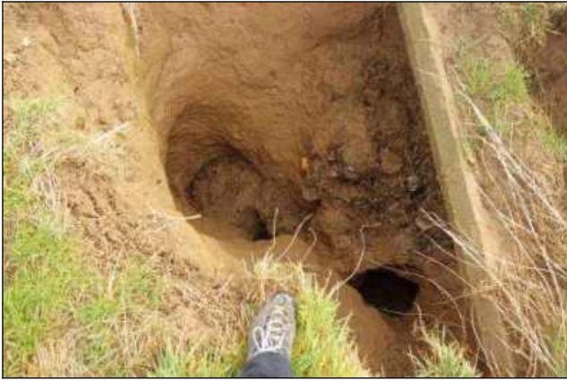
Abb. 12: Der Erdfall entstand im anstehenden Lösslehm. Am Grund des Einbruchs dienten zwei kolkartige Vertiefungen als Schlucklöcher.
